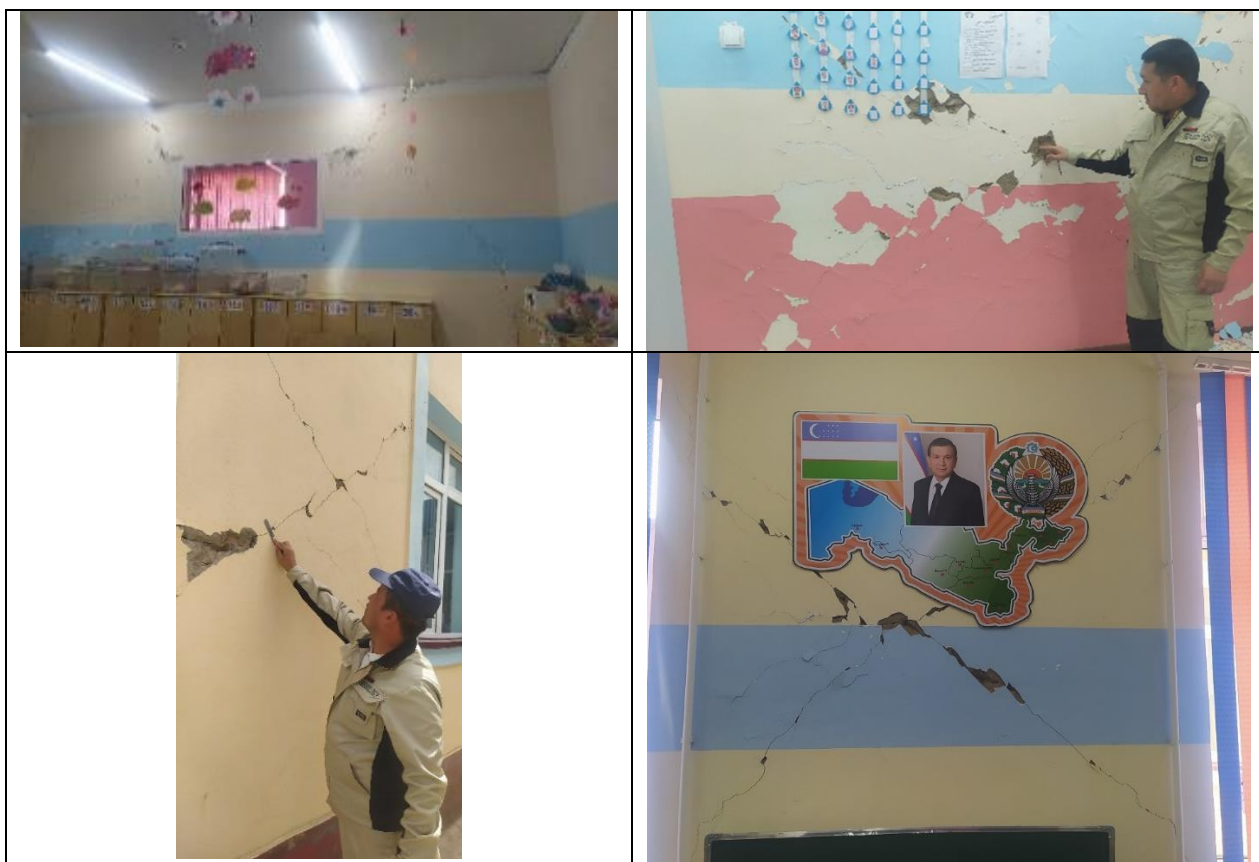
Рис. 6. Повреждение (глубокие сквозные трещины по всей стене, вывалы мелких блоков и обрушение большого куска штукатурки) стены здания детского сада.
