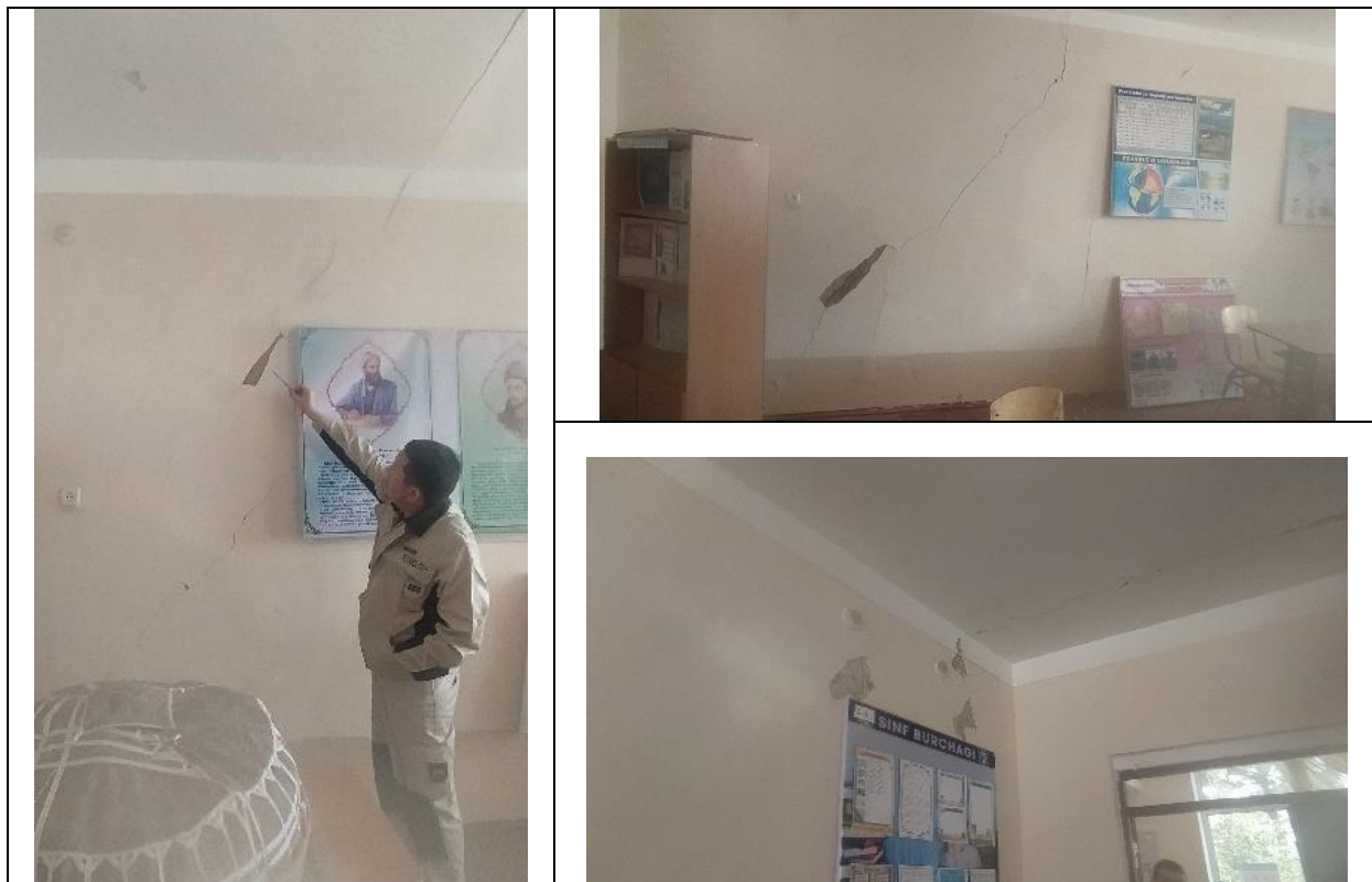
Рис. 5. Повреждение (диагональные трещины и обрушение большого куска штукатурки) стены учебного класса физики.
