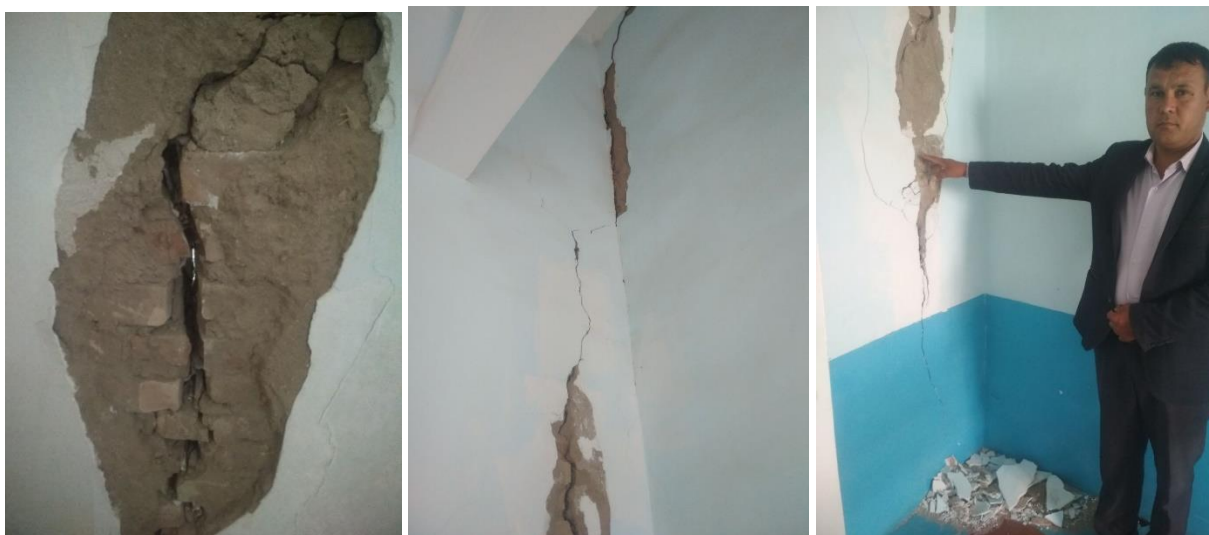
Рис. 8. Повреждение (широкое раскрытие трещин в стыках стен и потолка, глубокие сквозные трещины) стены здания.
