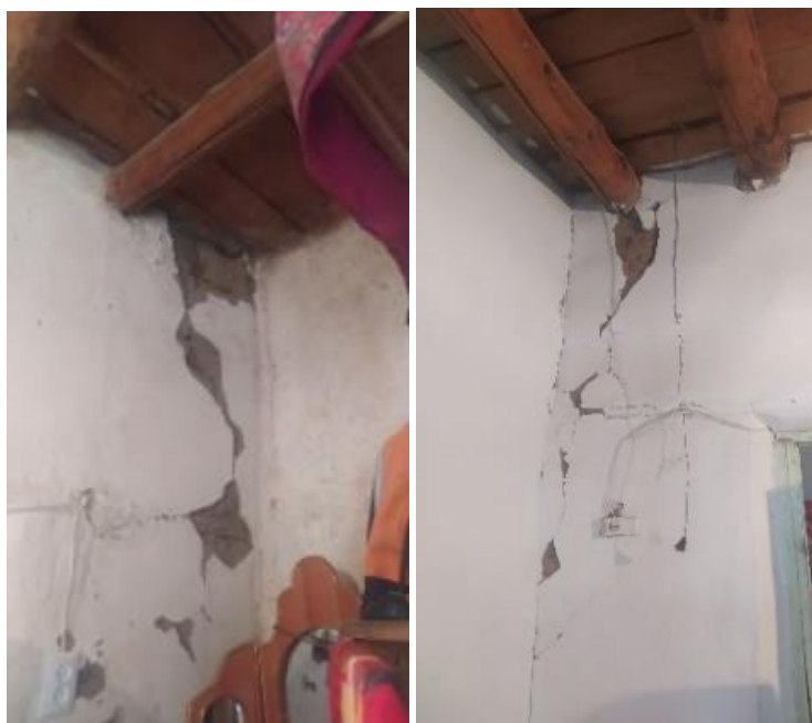
Рис. 7. Повреждение (широкое раскрытие трещин в стыках стен и потолка. Диагональные, вертикальные и горизонтальные трещины в несущих конструкциях, обрушение большого куска штукатурки) стены дома.
