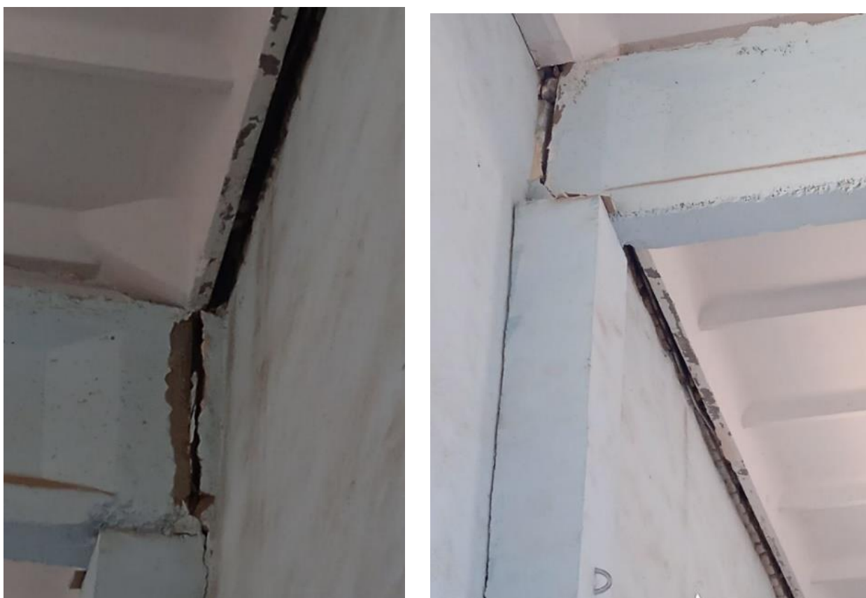
Рис. 9. Повреждение (глубокие сквозные трещины и сдвиг плиты) стены спортивного зала.
